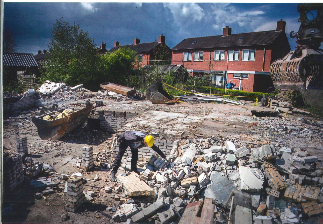
Een huis in het Groningse dorp Kantens is zo zwaar beschadigd door de aardbevingen dat het tot op de grond moest worden afgebroken. Veel andere woningen in Kantens zijn inmiddels ontruimd.
