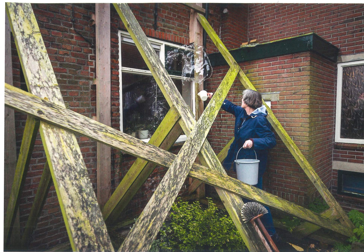
Liefke Munneke wast de ramen van haar boerderij in het Groningse Krewerd. Na de recente bevingen bleken stutten nodig om de boerderij bewoonbaar te houden. Liefke en haar man Jan zijn in overleg met de NAM over het herstel van de woning en de betaling ervan.
